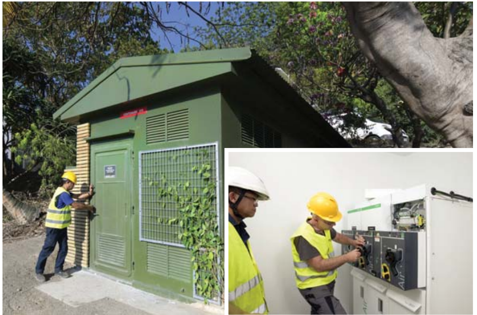
➤ Sur un transformateur pilote à Nouméa, Schneider Electric a lancé un nouveau tableau de distribution moyenne tension sans SF6, remplacé par de l'air pur filtré et déshumidifié.
